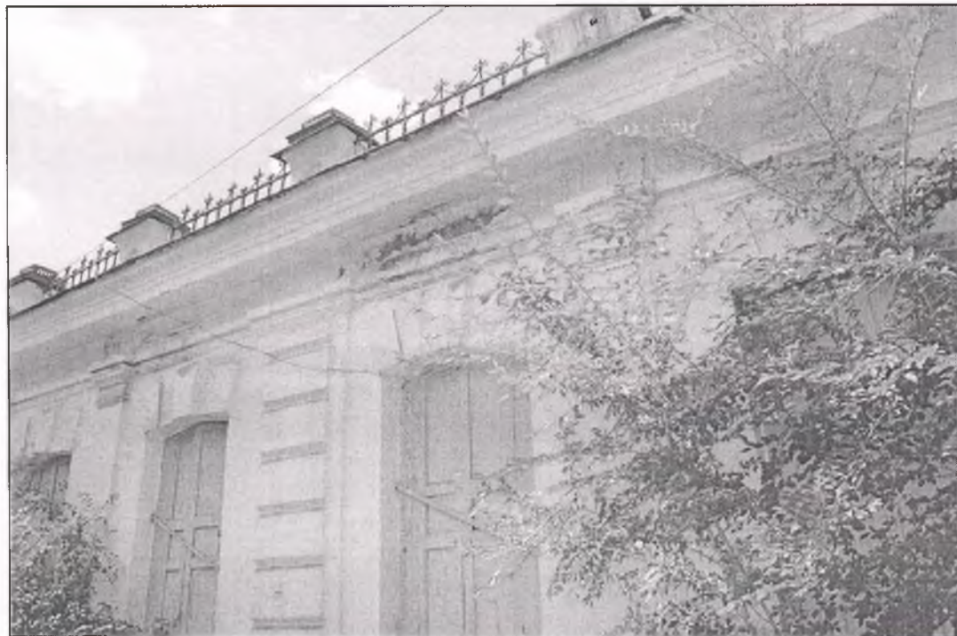
Фото 2 Юго-восточный фасад, фрагмент. Протечки кровли на главном фасаде.
